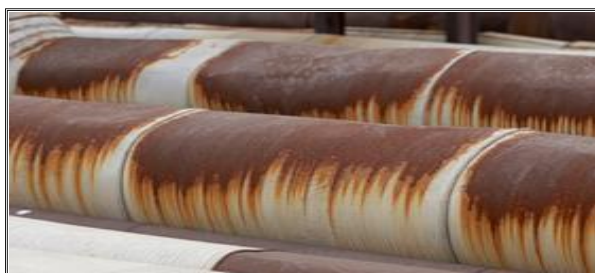
Figura 1. La corrosión en ductos.
