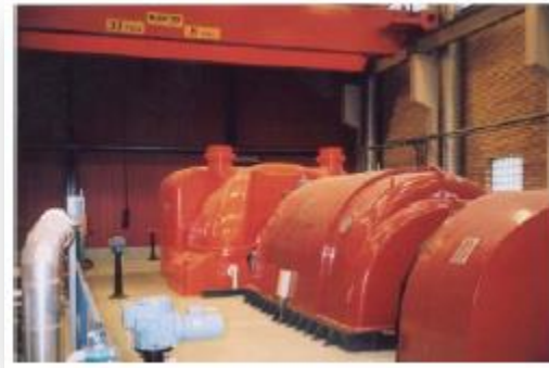
Figura 2.15 Turbina de vapor. Fuente: CRE.
