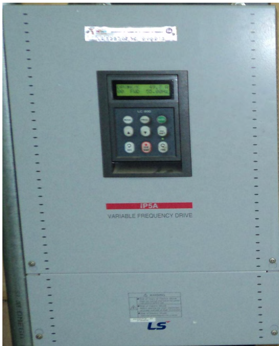
Fig. 2.24 Variador de Frecuencia a 45 Hz.
