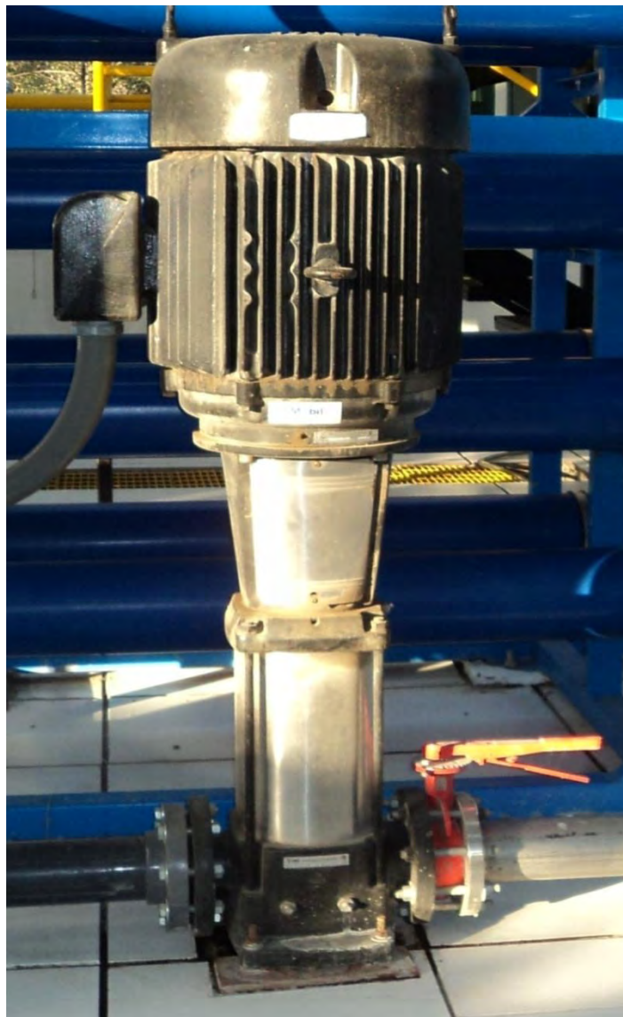
Fig. 2.14 Bomba de Alta Presión
