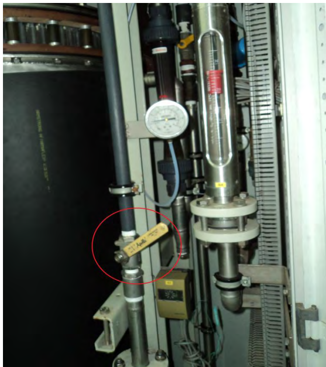
Fig. 2.12 Válvula para agua de enfriamiento del generador de ozono
