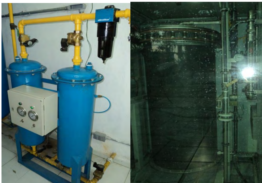
Fig 2.7 generador de ozono
