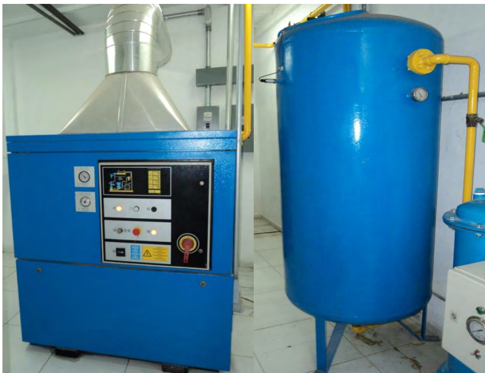
Fig 2.6 generador de ozono
