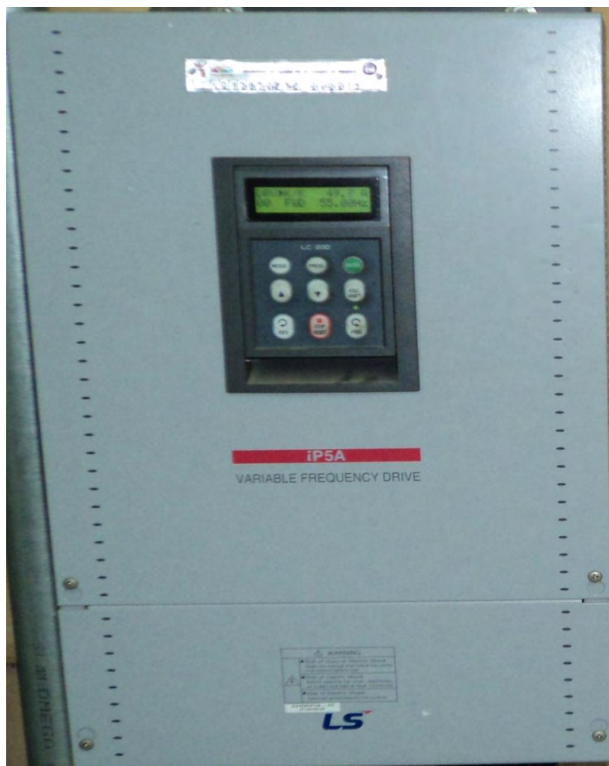
Fig. 2.23 Variador de Frecuencia a 48 Hz.
