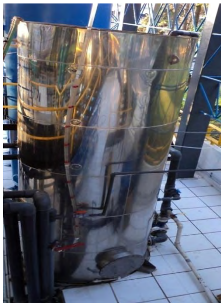
Fig. 2.19 Tanque de Ozonación visto desde fuera.
