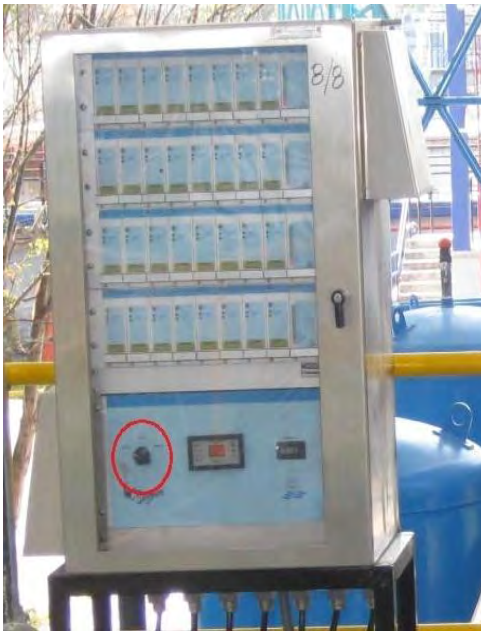
Fig. 2.26 Tablero de Control de Luz Ultravioleta.
