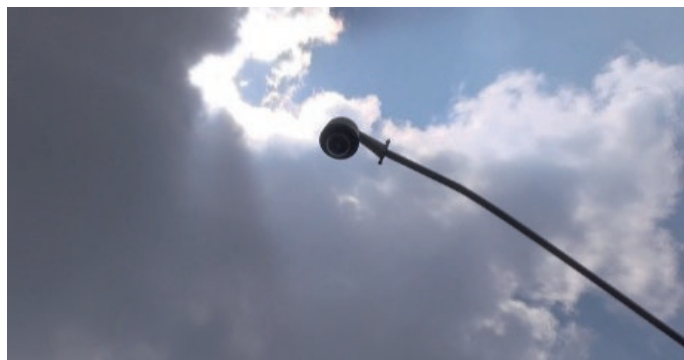
Cámaras de vigilancia
